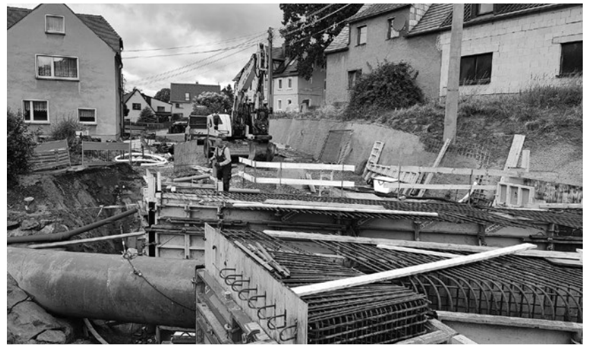
Die Eisenflechtarbeiten sind abgeschlossen, inzwischen sind die Betonarbeiten angegangen. Rechts das Haus Hauptstraße 223, jetzt im Eigentum der Gemeinde.
