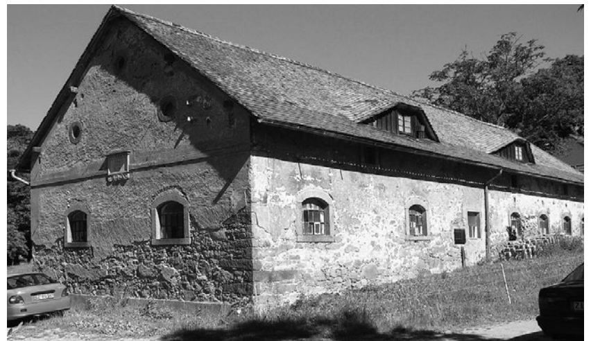
Der sogenannte „Pferdestall“ auf dem „Oberen Hof“ am Polenzpark vor der Sanierung. Der Bedarf war groß.
