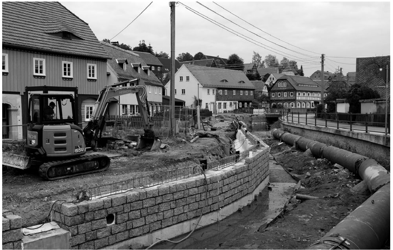
Baustelle Erlenweg. Die Stützmauer ist so gut wie fertig, bald wird das Bachbett hergestellt.
