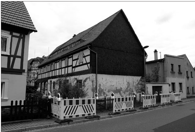
Das Haus Hauptstraße 10 wird abgerissen, noch in diesem Jahr wird das vollzogen.
