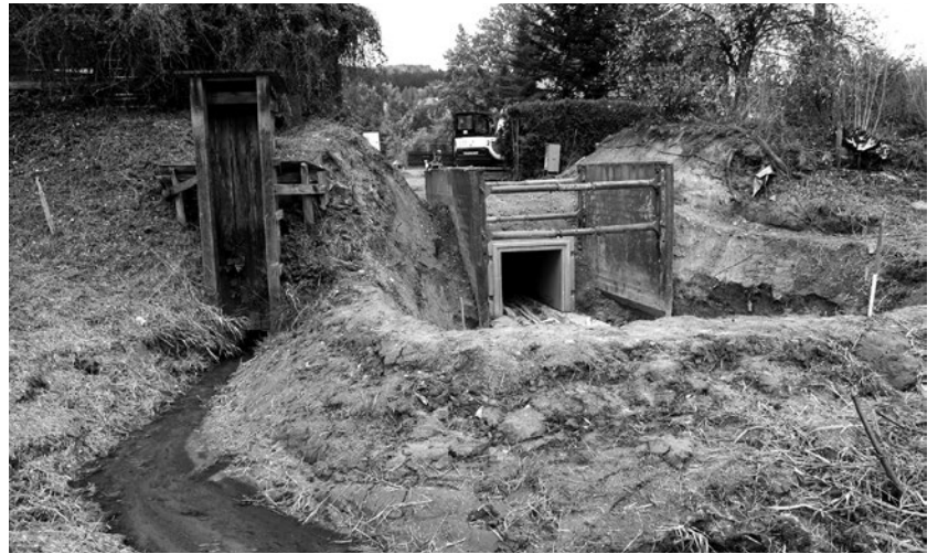
Der alte hölzerne Überlauf hat bald ausgedient, ebenso der alte Kanal, durch den das Neuweigsdorfer Wasser zum Dorfbach fließt. Ausgebaut wird der Altkanal allerdings nicht.
