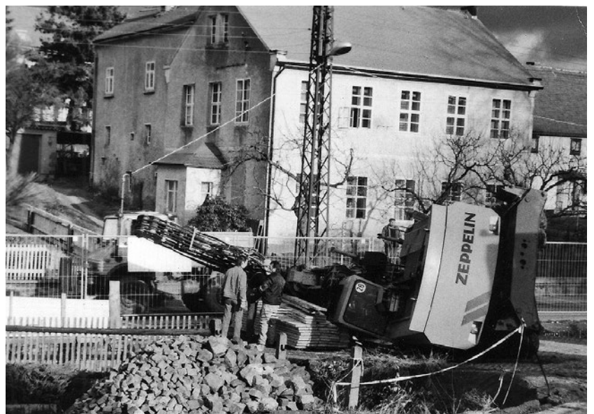
Glück im Unglück hatte der Baggerfahrer 1996 an der Bielebohstraße. Bei Bauarbeiten waren Brückenteile eingebrochen, der Fahrer blieb unverletzt, die Bergung war kompliziert.
