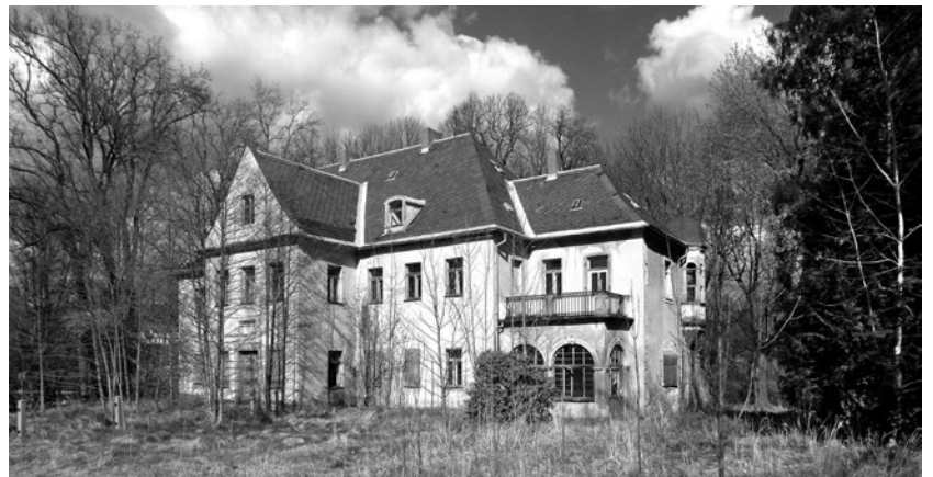
Aktuell sieht es nicht gut aus für das Weigsdorfer Schloss. Sowohl das Gebäude als auch das Umfeld benötigen dringend der Werterhaltung, Sanierung und Pflege.
