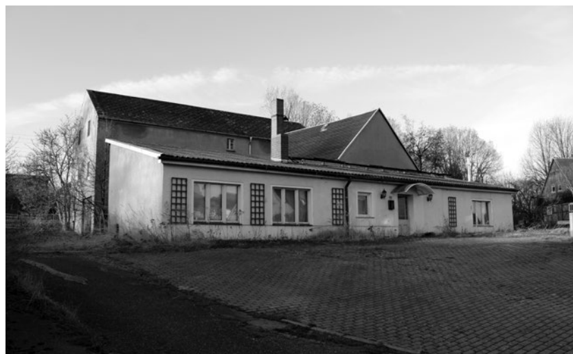
Einst BHG-Lager, BHG- und LPG-Büro, später „Kleines OEZ“ und Getränkemarkt. Zukunftsprognose: Nicht sanierbar, Abriss unvermeidlich.
