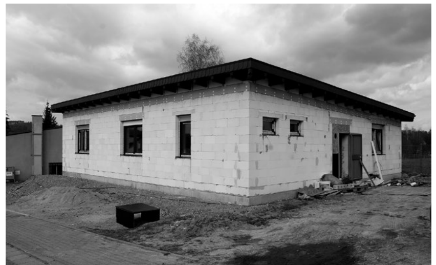
Am neuen Therapiehaus an der Bielebohstraße ist noch reichlich Arbeit. Im August/September soll alles fertig sein.
