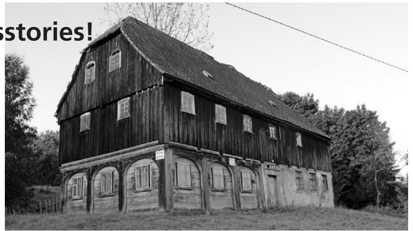
Hauptstraße 114. Nach jahrzehntelangem Leerstand ist hier wohl nichts mehr sanierbar.
