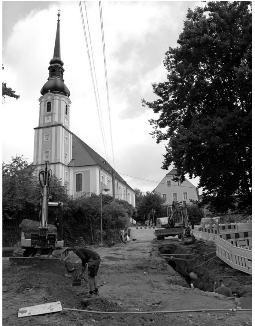
Die Bauarbeiten auf dem Kirchweg sind in vollem Gange. Die Zufahrt zum Blumenhaus ist erschwert, am besten man geht zu Fuß.
