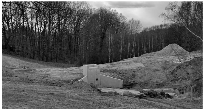
Im „Schwarzen Winkel“ wird der beim Hochwasser 2010 beschädigte Anstau als Staudamm wiederhergestellt, ein auch aus Sicht des Naturschutzes wichtiges Vorhaben.
