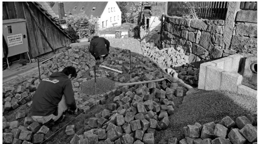
Die Stützmauer im Mitteldorf ist längst fertig, noch sind Pflasterarbeiten im Gange.
