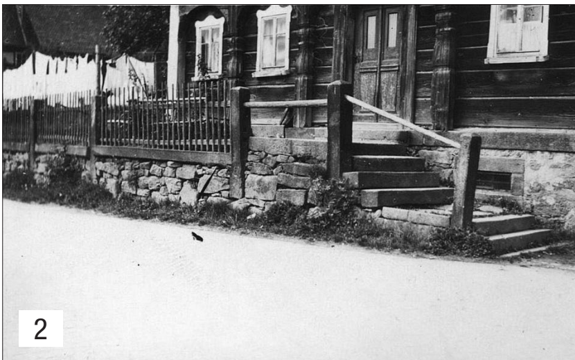
Umgebindehaus mit Treppenzugang - an dieser Situation hat sich nicht viel geändert. Wo sind wir?
