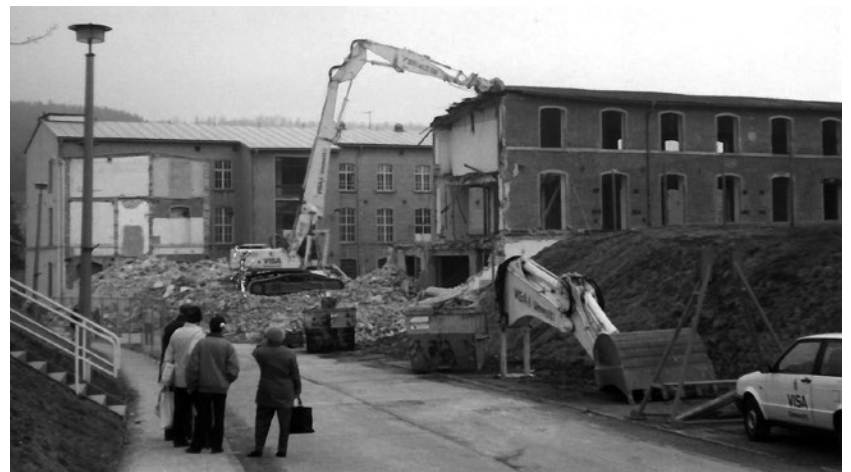
Mai 1996. Abriss nicht mehr benötigter Altsubstanz des ehemaligen Werk V des Motorenwerkes in Köblitz, neue Produktionshallen entstanden.
