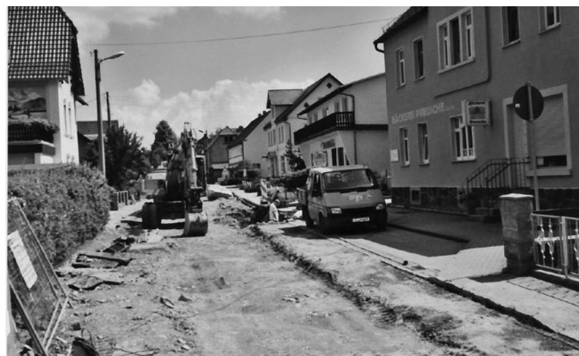
Juni 2004. Im Zusammenhang mit dem Stützmauerbau in Niedercunewalde wurde auch die Hauptstraße vom Knoten Bahnhofstraße bis Kirchweg ausgebaut.
