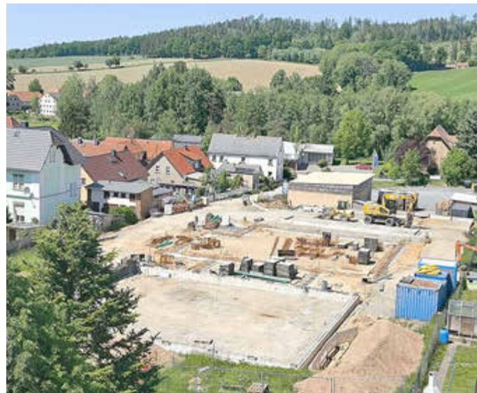
Aktueller Baustand der kombinierten Kinderkrippe und Altpflege in Weigsdorf-Köblitz: Das Gebäude nimmt erste Konturen an!
