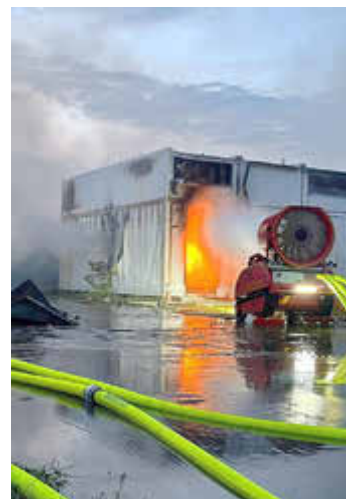
Der brennende Batteriespeicher in Bautzen - zum Einsatz kam auch spezielle Technik, wie ein Lösch-Unterstützungsfahrzeug der Berufsfeuerwehr Dresden.
